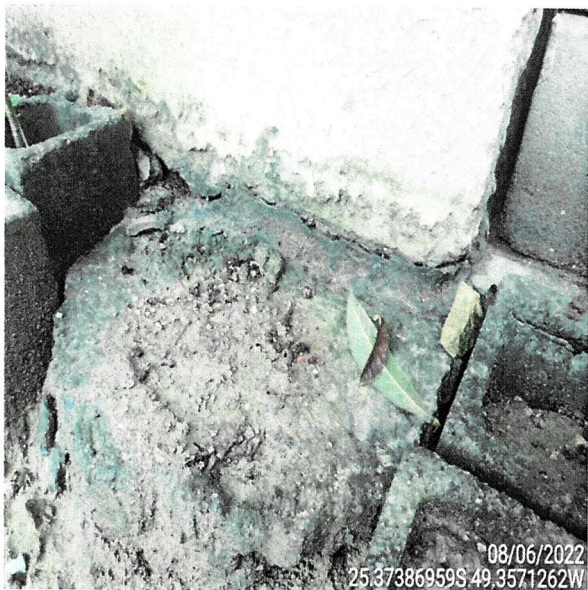
Fotos 12: Vista broca E7 – visível retração.
