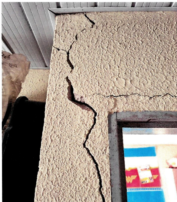
Fotos 15: Vista Interna – ausência de vergas
