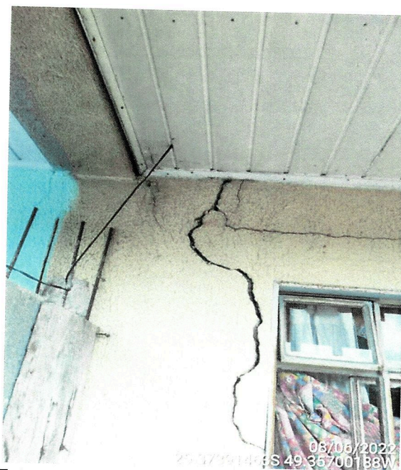
Fotos 21: Vista Geral – rachaduras
