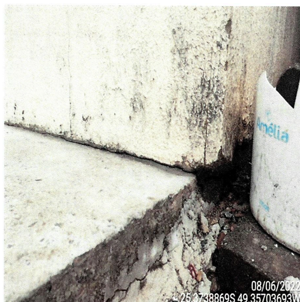
Fotos 13: Vista broca E33 – visível retração.
