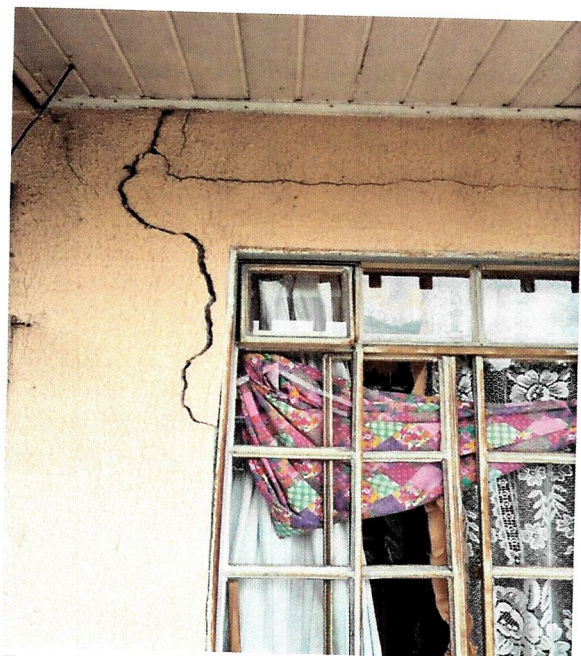
Fotos 20: Vista Geral – rachaduras
