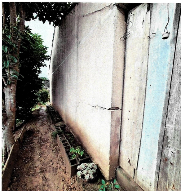
Fotos 14: Vista geral – visível retração.
